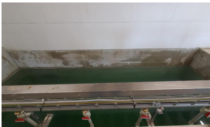
Obr.: Nitrifikační nádrž
